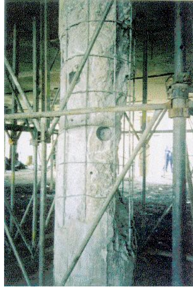
(a) Pilar atingido pelo incêndio no Aeroporto Santos Dumont, Rio de Janeiro, 1998 [12]
