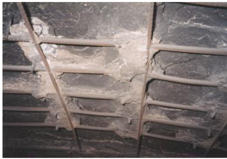
(b) Armadura exposta após incêndio no Chanel Tunnel, França - Inglaterra [13]
