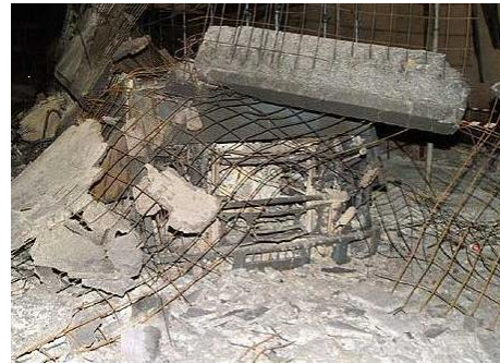
(c) Colapso estrutural do Gotthard Tunnel, Suíça [13]
