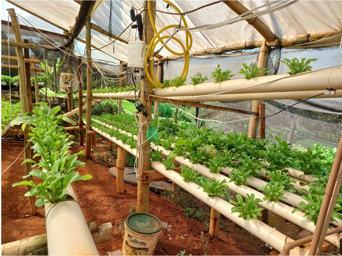
Figura 1: Visão geral da instalação do sistema de monitoramento em estufa hidropônica, com destaque para os sensores e cabeamento.
